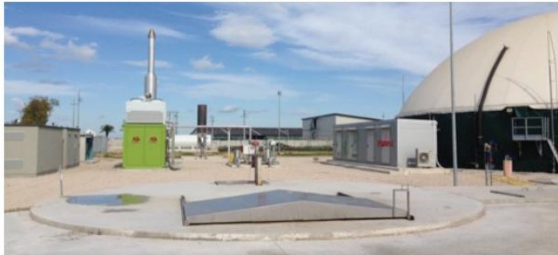
Prevasca di miscelazione e carico digestore
