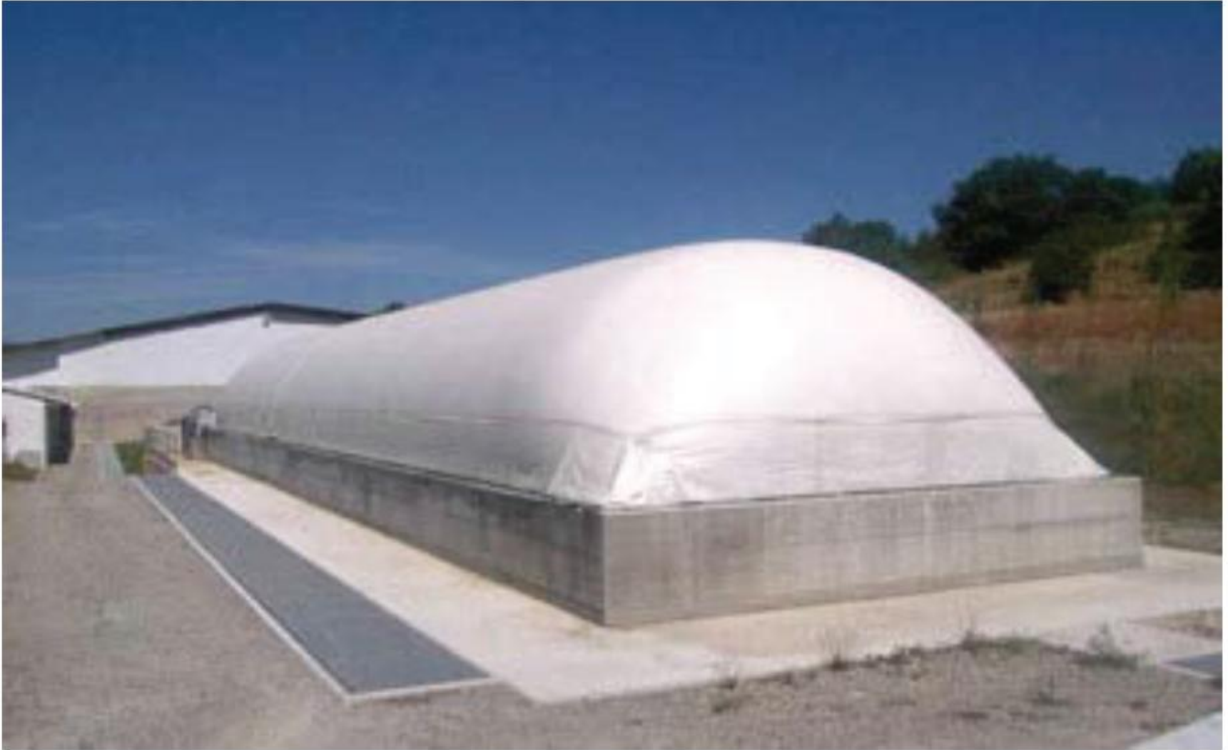
Digestore orizzontale – Plug-Flow (Rota Guido)
