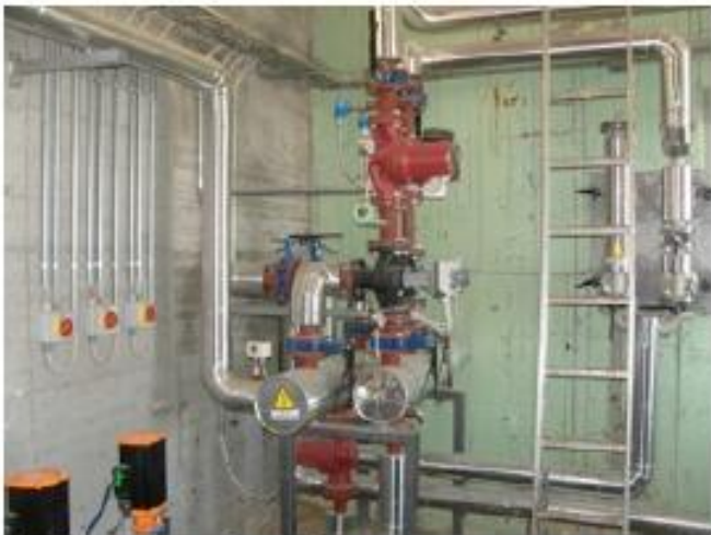
Pompa circolazione acqua calda
