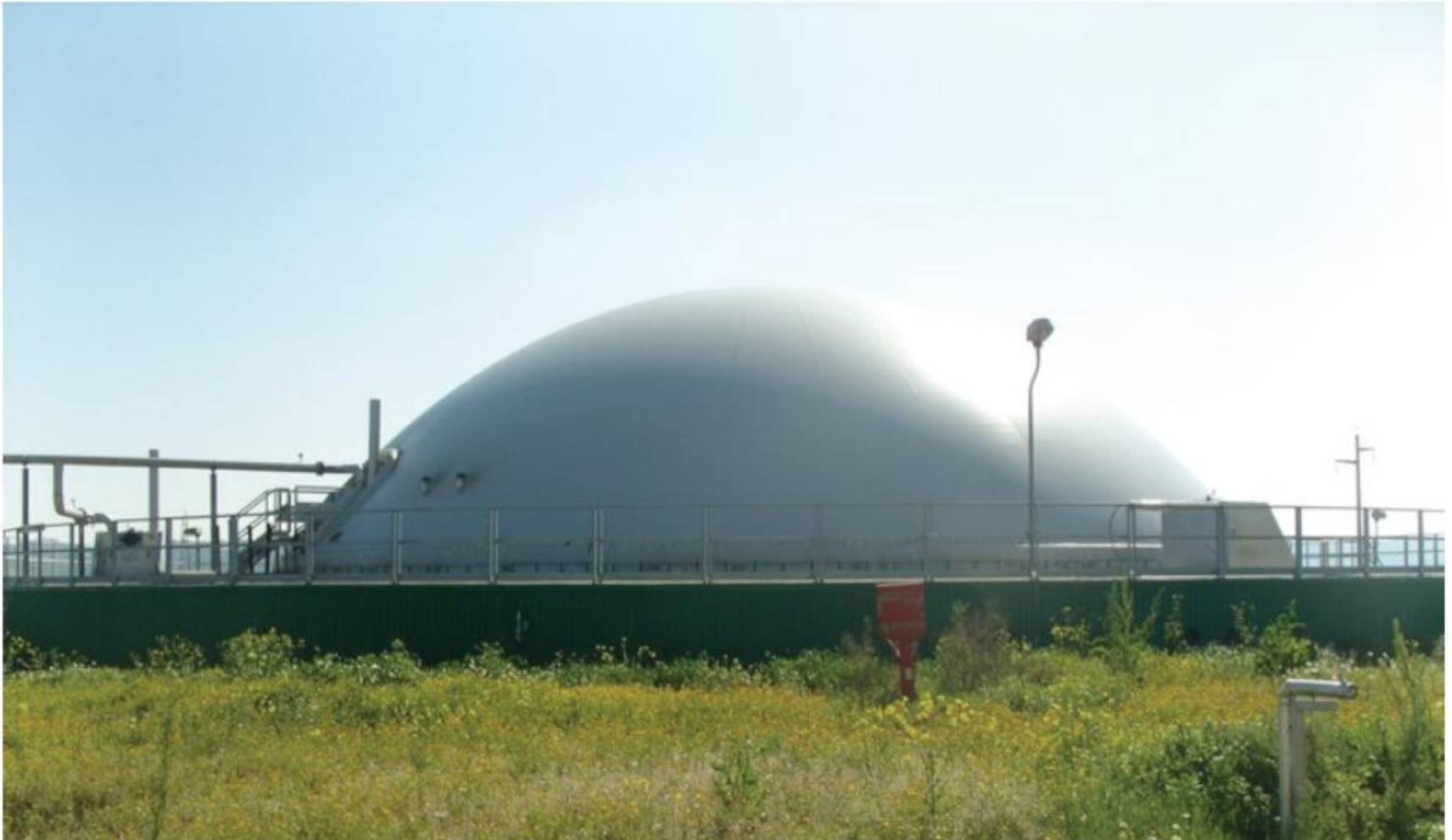
Digestore verticale bistadio 1.000 kWe
