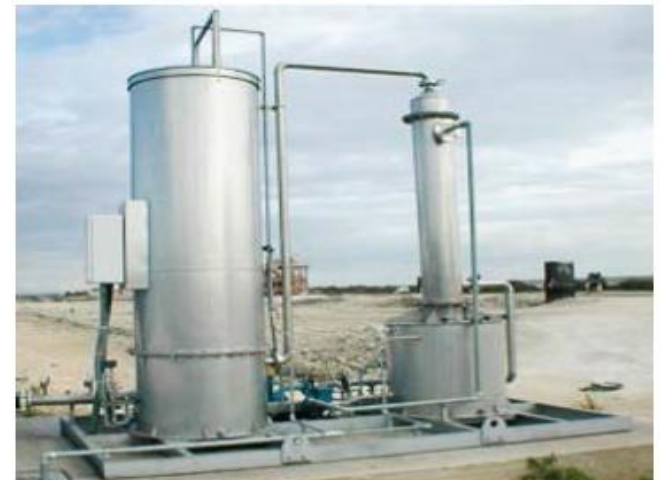
Scrubber desolforazione (Progeco)
