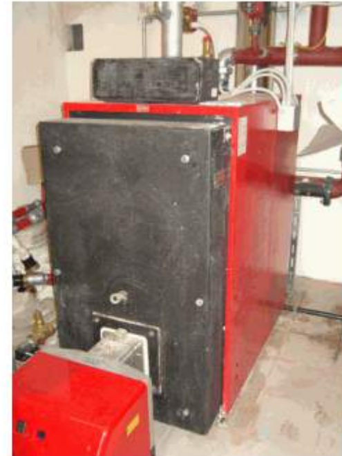
Caldaia + bruciatore 250 kW
