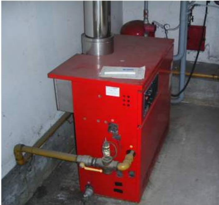
Caldaia atmosferica condominiale 200 kW
